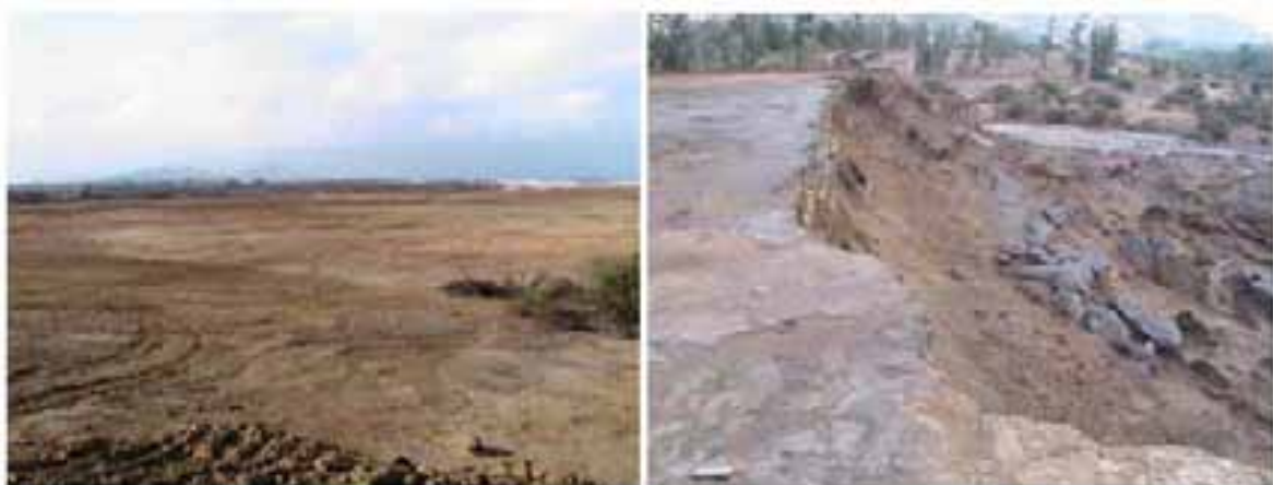
Foto 5: Tranques de Relave sin presencia de Vegetación y con problemas de Erosión
